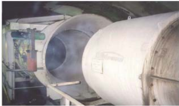
Электростанция в Манароуги, Новая Зеландия. Плавный пуск для вентиляторов, насосов и лебедок.
